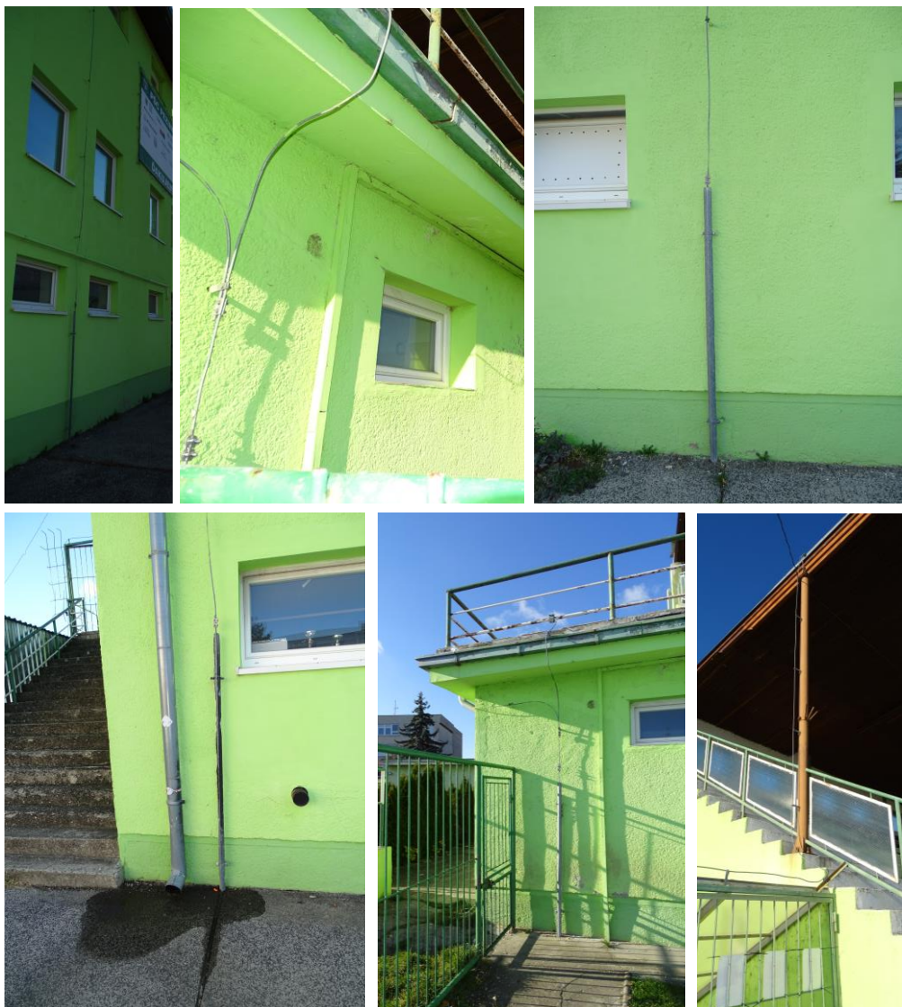
Obr. č. 18 – Bleskozvod
