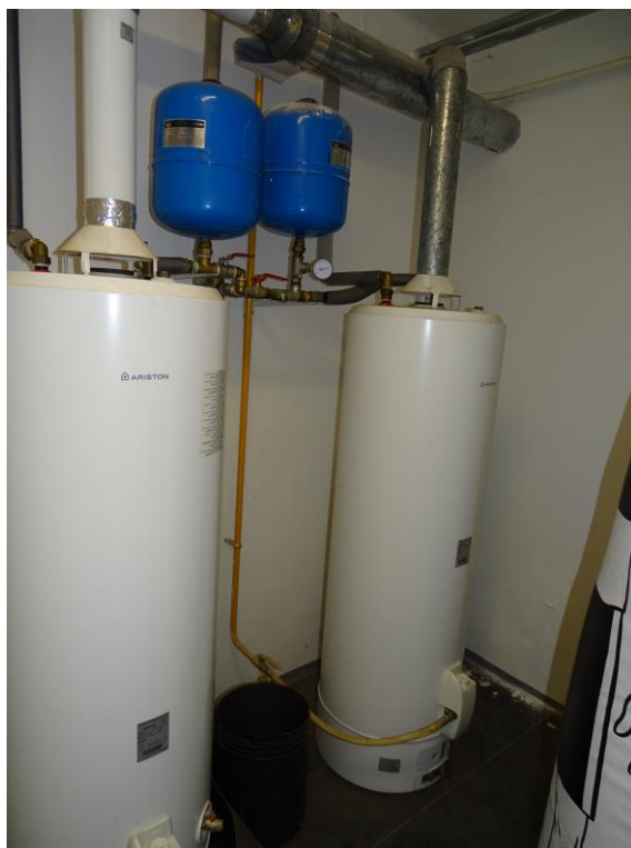
Obr. č. 15 Vykurovanie – zásobník TUV v kotolni, 2x plynový kotol v kotolni, ocelové rozvody vykurovania, plechový teplovodný radiátor, plynové zásobníky TUV .
