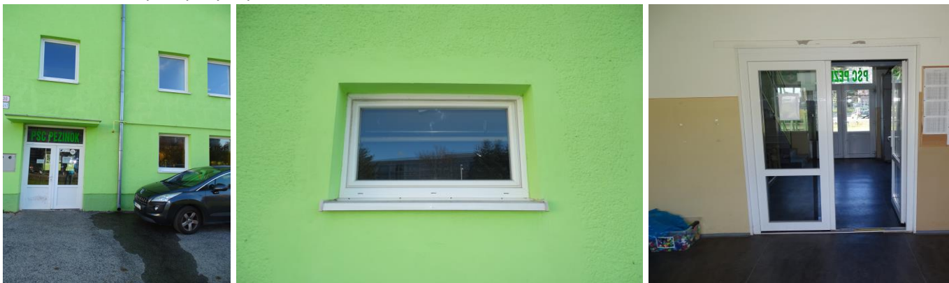
Obr. č. 4 - Otvorové konštrukcie – plastové vstupné dvere s presklením, plastové okno v plastovom ráme s plastovým parapetom.
