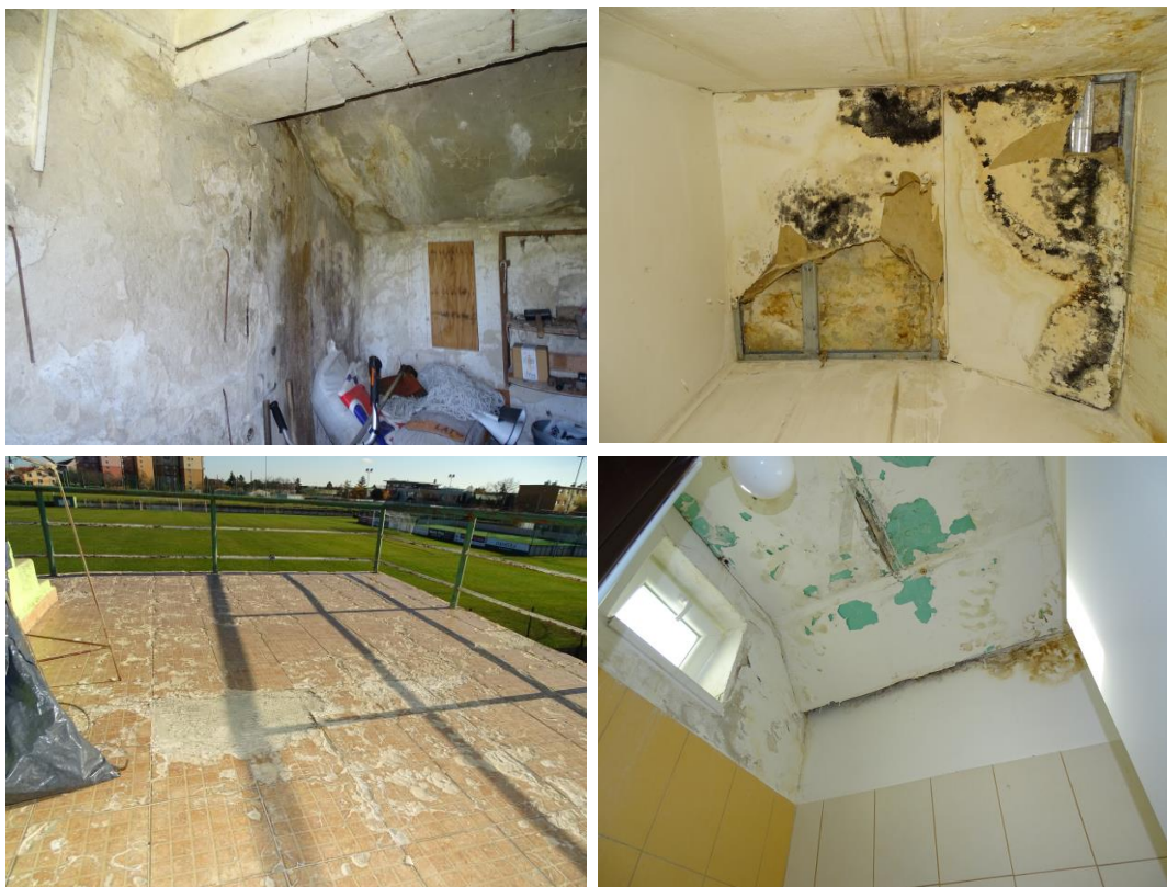
Obr. č. 7 – poškodenie stien a stropov vzniknuté zatekaním cez exteriérové schodiská vedúce na tribúnu
