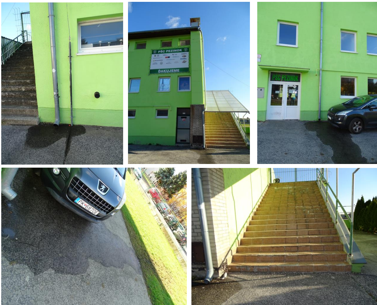
Obr. č. 13 Dažďové vody v čelnej časti budovy vyvedené priamo na chodník.
