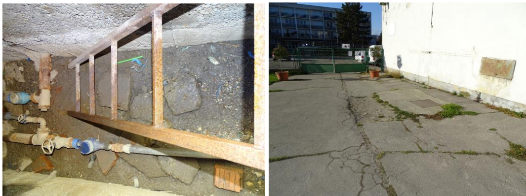
Obr. č. 12 Vodomerová šachta, umiestnenie šachty pred objektom.
