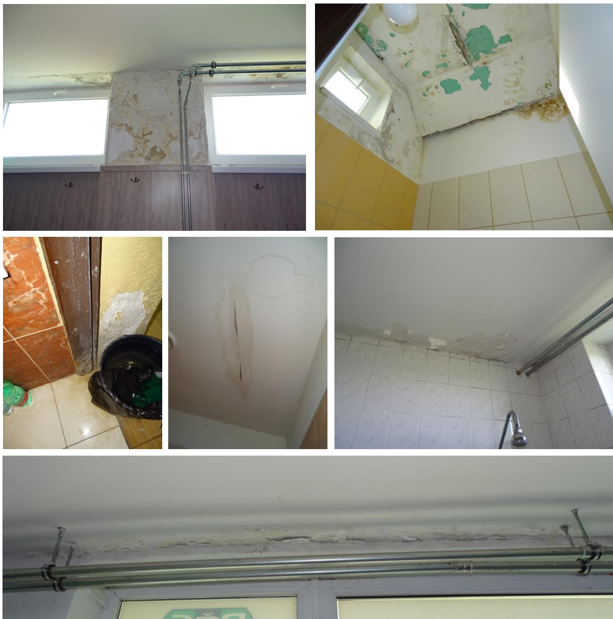
Obr. č. 5 – Úpravy stien interiéru – defekty v garáži pod schodiskom, plesnivé zatečené stropy pod schodiskom vo WC a na chodbe, trhliny v šatni, plesnivá stena v práčovni pod schodiskom, plesnivý strop v sprchách, trhliny nad oknom v šatni.
