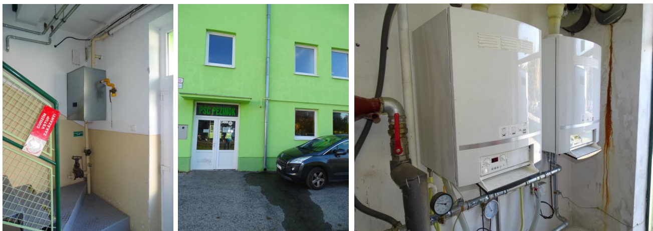
Obr. č. 14 Plynomerné zariadenie vo vstupnej hale, vedenie plynu po fasáde smerom do kotolne, kotolňa (2x PK Buderus).
