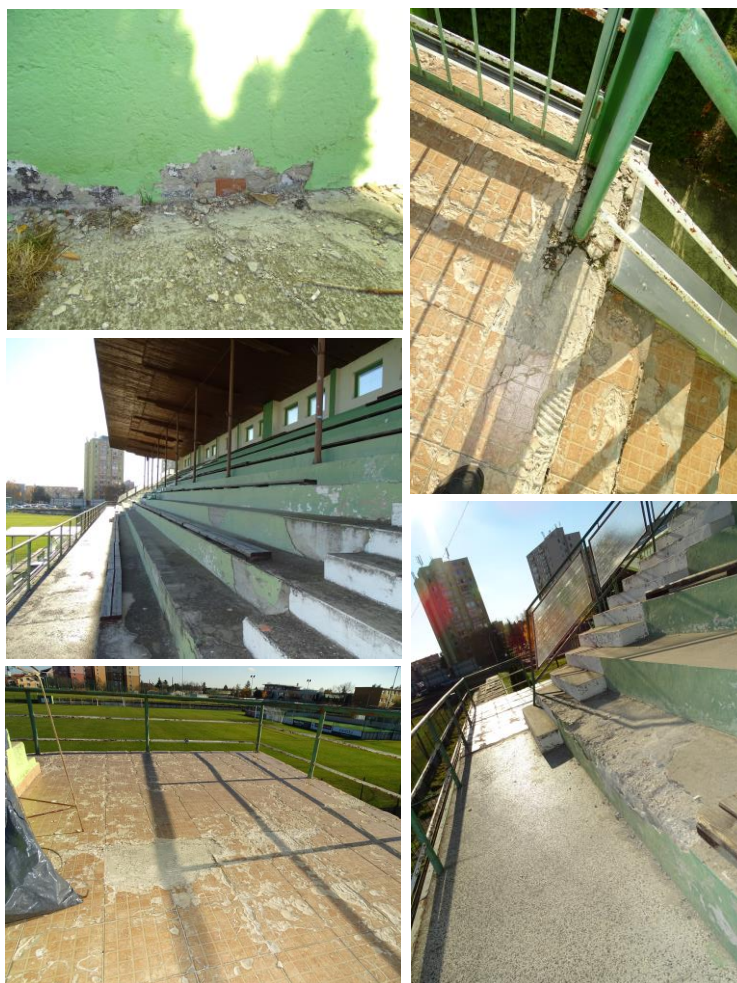
Obr. č. 3 – Pohľady na porušenú fasádu objektu – opadaná omietka z navlhnutých a zmrznutých miest pri teréne, narušená keramická dlažba na schodisku, narušená omietka na tribúne
