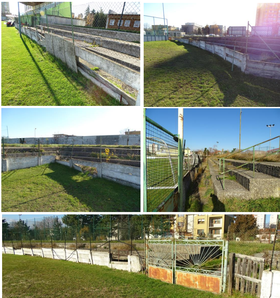
Obr. č. 10 – Vnútorné oplotenie – poškodené betónové segmenty, torzo pôvodnej betónovej tribúny, bočná oceľová brána vo vnútornom oplotení.
